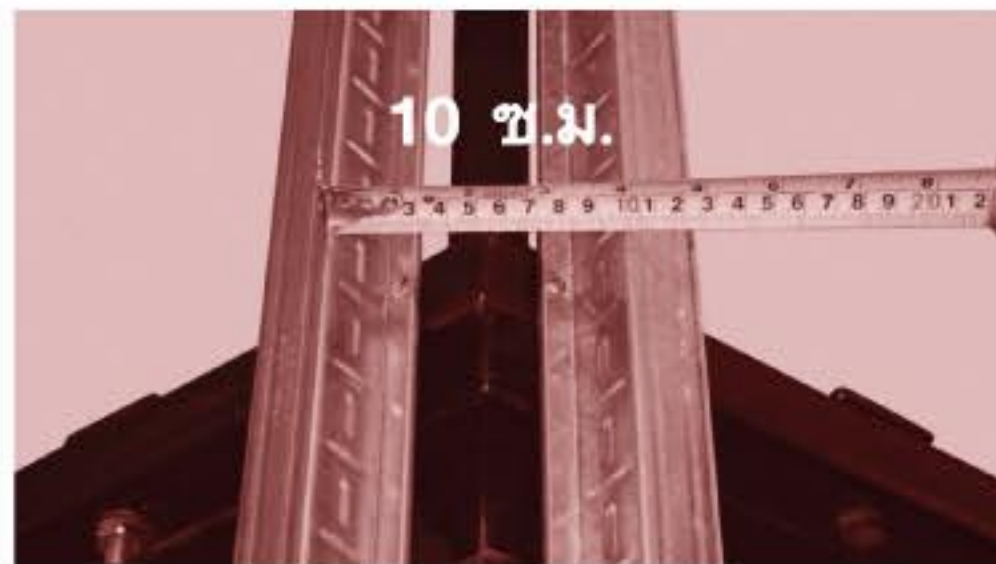
1. ตรวจสอบระยะแปคู่บนที่สันหลังคา ต้องห่างกัน 10 ซม.
