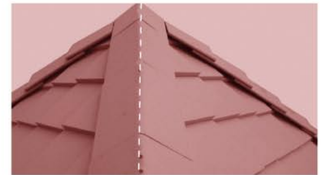
10. จัดเรียงครอบสันหลังคาตลอดแนวเพื่อทำการเฉลี่ยระยะครอบ ซึ่งสายเอ็นที่มุมยอดของครอบ ปิดจั่วทั้งสองด้าน เพื่อบังคับแนวแล้วยึดครอบสันหลังคาเข้ากับเหล็กยึดครอบด้วยตะปูยึดเกลียวยึดกระเบื้อง 2.5 นิ้ว-ปลายสว่านทุกแผ่นๆ ละ 2 ตัว
