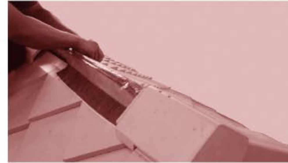
5. นำครอบสันหลังคามาวางเพื่อกำหนดแนวการติดตั้งแผ่นรองใต้ครอบ โดยแผ่นรองใต้ครอบเมื่อติดตั้งแล้วไม่เป็นพื้นชายครอบ และต้องคลุมหัวกระเบื้องสันหลังคาประมาณ 8 ซม. แล้วทำเครื่องหมายเพื่อกำหนดแนวการติดตั้งแผ่นรองใต้ครอบตลอดแนวสันหลังคาทั้งสองข้าง
