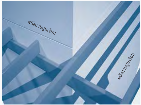
1. ฉาบปูนผนังให้เรียบร้อยติดตั้งจันทันตัวแรกให้ชิดแนบผนัง
